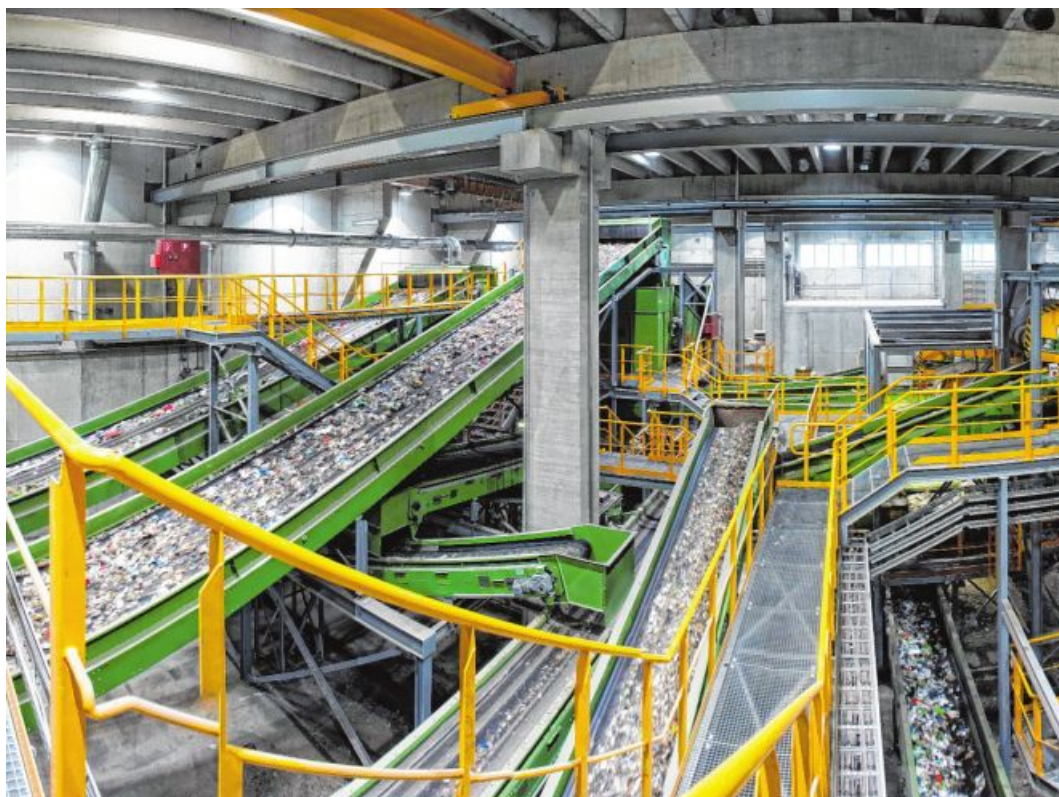
Auf insgesamt rund 800 Meter langen Förderbändern wird der Müll sortiert.
