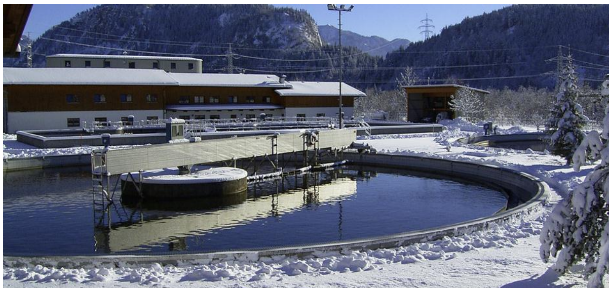
Mehr als fünf Millionen Kubikmeter Abwasser werden jedes Jahr in der Kläranlage in Vils gereinigt. Foto: ARA
