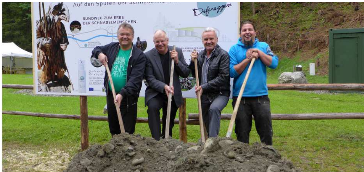
BM Gerald Hauser, Ernst Fleischhacker, GF Egon Kleinlercher und Künstler Michael Lang (von links) beim Spatenstich für die neue Anlage. Foto: Blassnig
