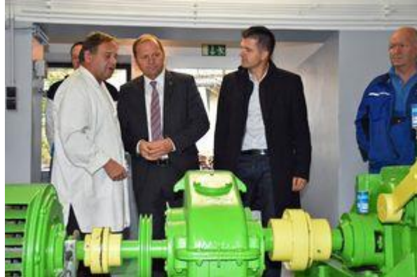
v.li.: Andreas Bischofer (im Hintergrund, Elektrounternehmen), Vinzenz Leitner (Metzgermeister und Kraftwerksbetreiber), LHStv Josef Geisler, Rupert Ebenbichler (Wasser Tirol) und Christian Steiner (ausführende Firma MSK).
