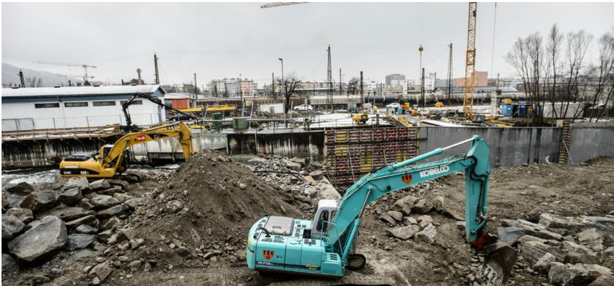
An der Sill (Wehranlage Tivoli) wird derzeit eine Fischrampe gebaut. Foto: Böhm
